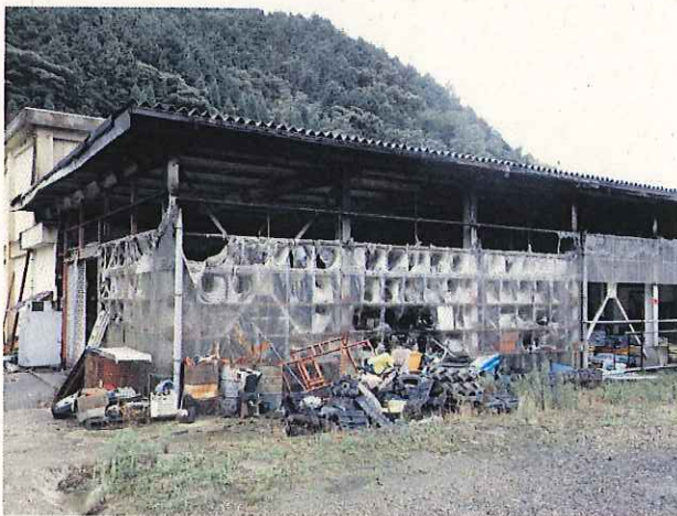
綾部西部営農経済センターの被災(落雷火災)状況
