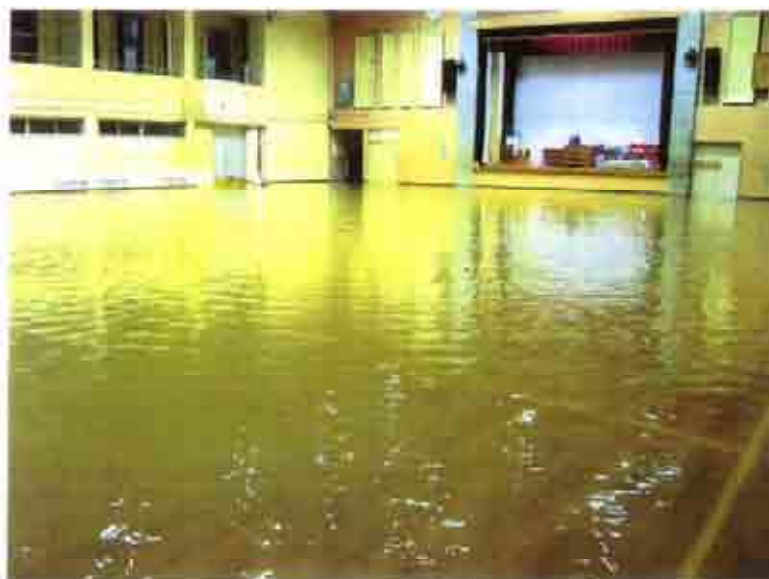
中学校体育館の浸水(京丹後市)
