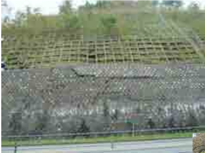
法面崩壊 (舞鶴若狭自動車道)
