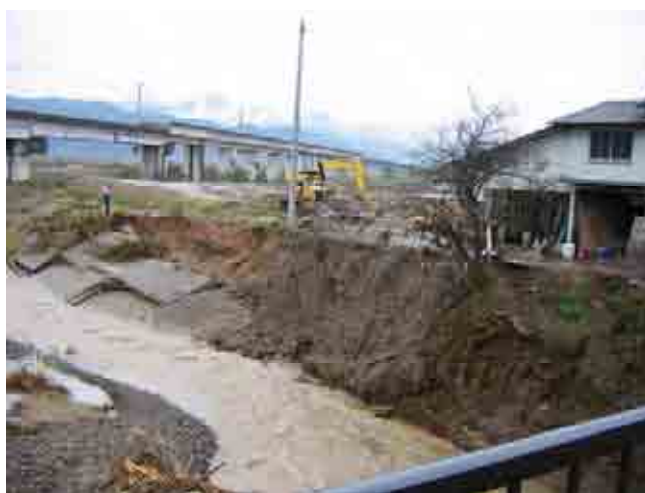
護岸崩壊 (宮川)
