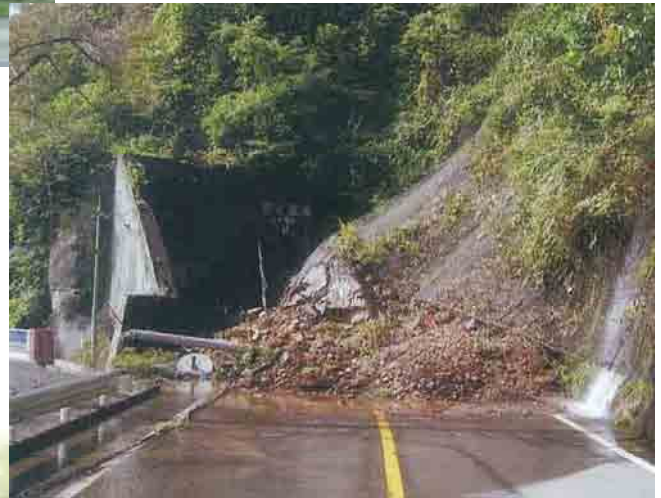
崩土 (府道綾部宮島線)
